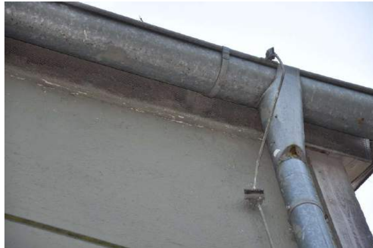
Traufblech (Gebäude A)
