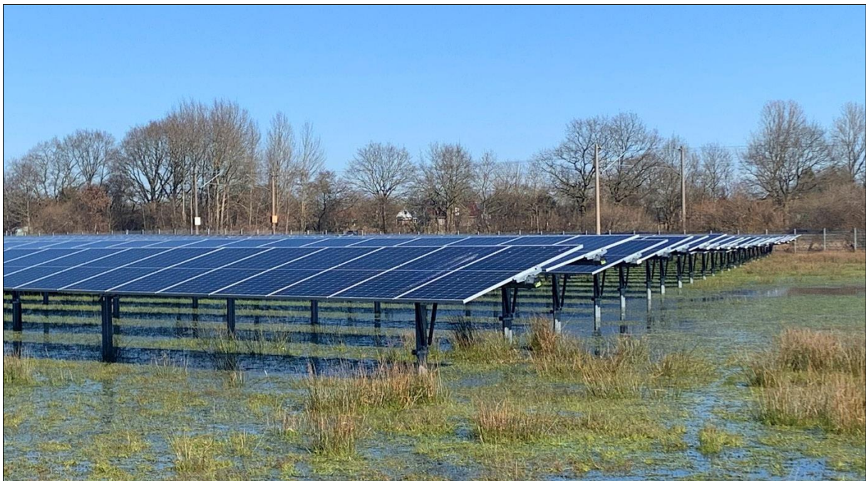
Abbildung 12: PV-Anlage auf wiedervernässtem Moorboden, Solarpark Lottorf in Schleswig-Holstein ( https://www.naturschutz-energiewende.de/fachwissen/veroeffentlichungen/photovoltaik-auf-wiedervernaessten-moorboeden-eine-neue-flaechenkulisse-im-eeq-2023/ )
