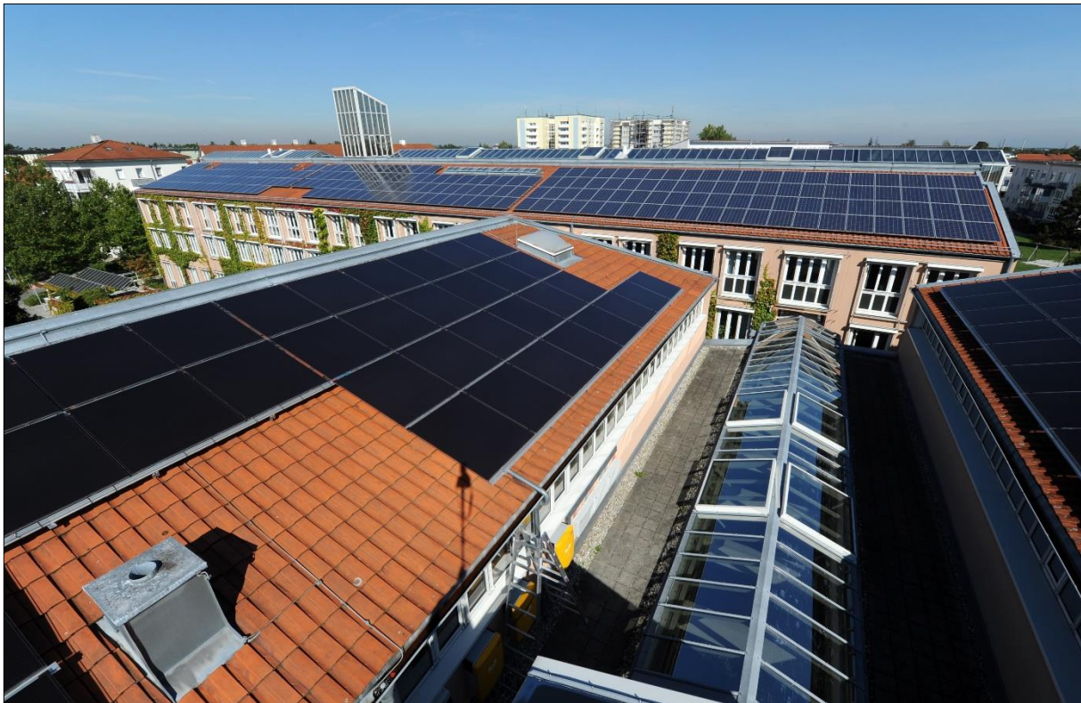
Abbildung 14: PV-Anlage auf dem Rathaus und dem Ratsgebäude (Foto Solarpark Garching, September 2010)
